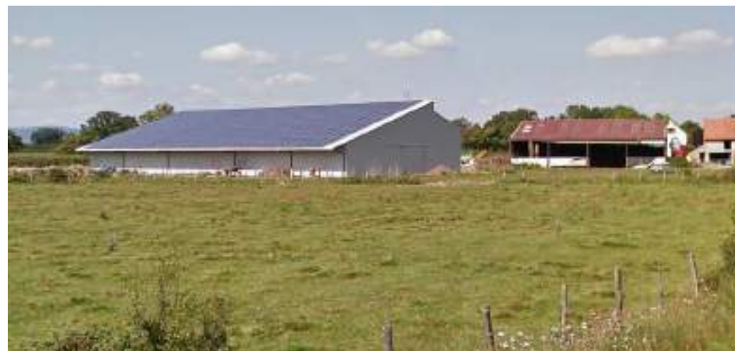
Près de 1000 m 2 de panneaux installés sur le toit d'un bâtiment d'élevage à Dracy-Saint-Loup
